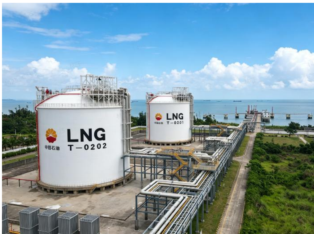
图：两座2万立方米的LNG储罐
